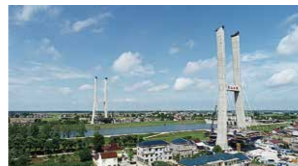
位于望江县的G347安九二期望江至宿松段一级公路PPP项目，全长13.26公里，造价7.81亿。
