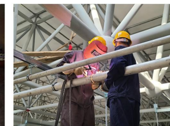
拍摄者：胡金涛 阜阳卷烟厂劳务班 组人员在钢格栅上进行管道焊接
